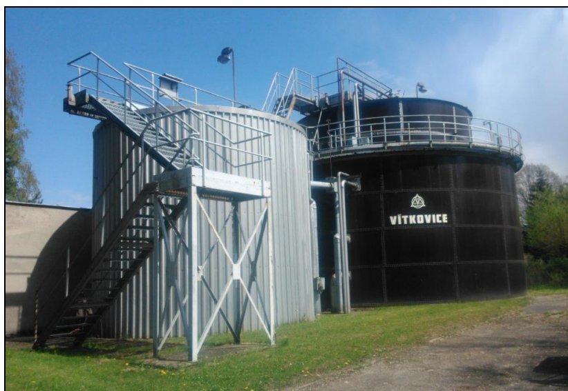
Obrázek 3: Pohled na ČOV Rohovládová Bělá
